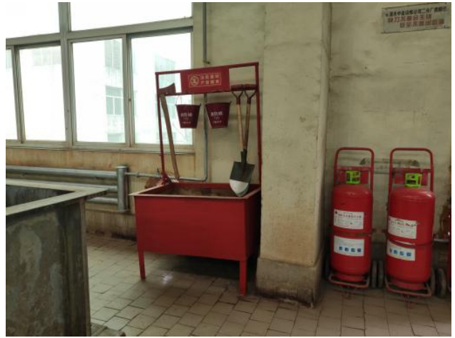
车间灭火器材
