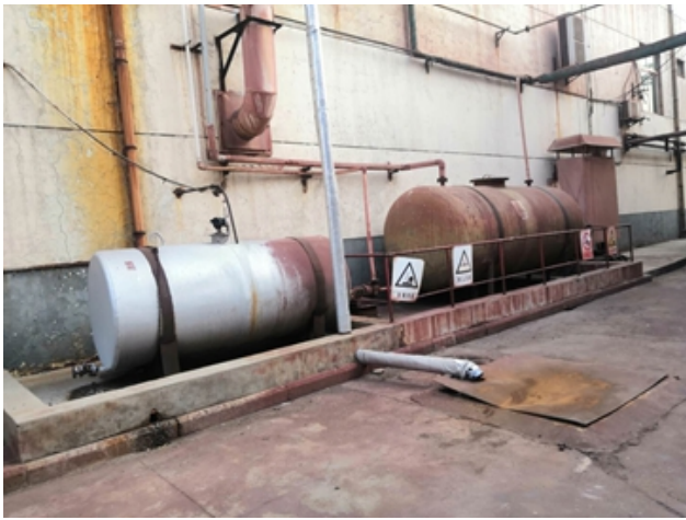
精炼车间西侧罐区（左硝酸，右盐酸）
