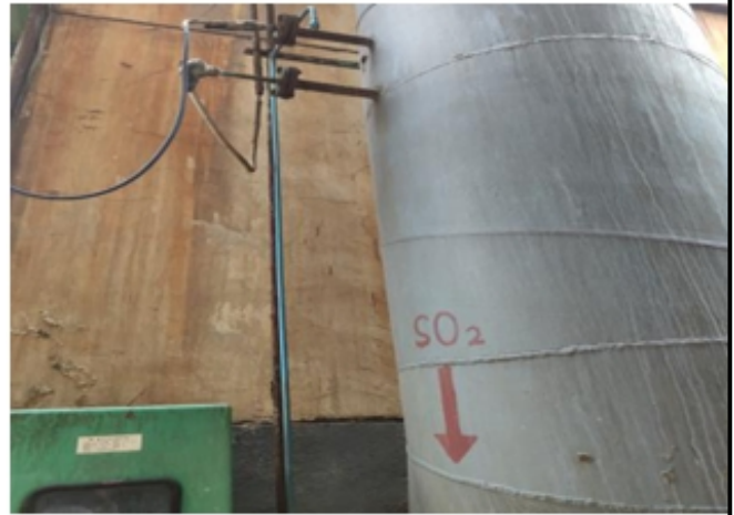
SO 2 输送管道
