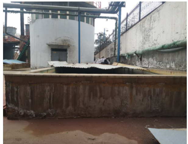
污水站事故池
