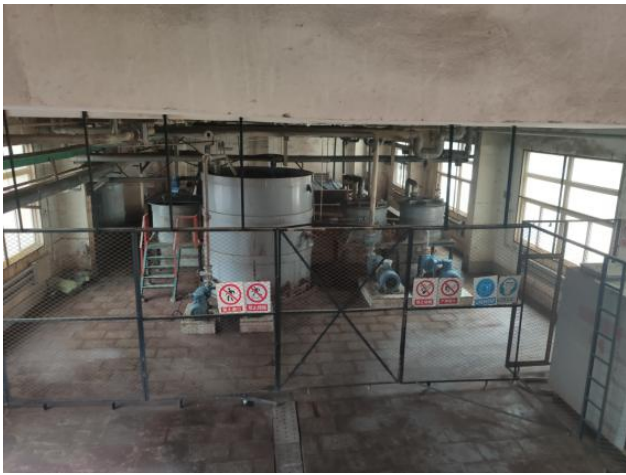
电铜车间富铜液池及有机相池
